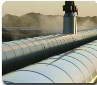
LNG pipeline insulation
